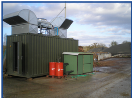
Installation d'un système de méthanisation à Vic Fezensac
