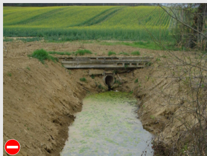
Passage busé non conforme et mal posé provoquant une rupture de l'écoulement.
