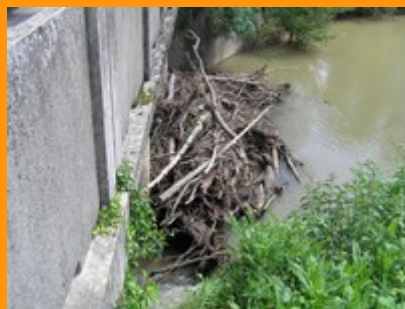
Accumulation d'embâcles sur les piles d'un pont : risque de rupture d'ouvrage et d'inondation.
