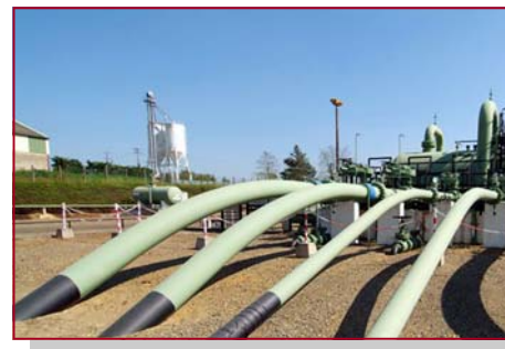
Stockage de gaz naturel d'Izaute
